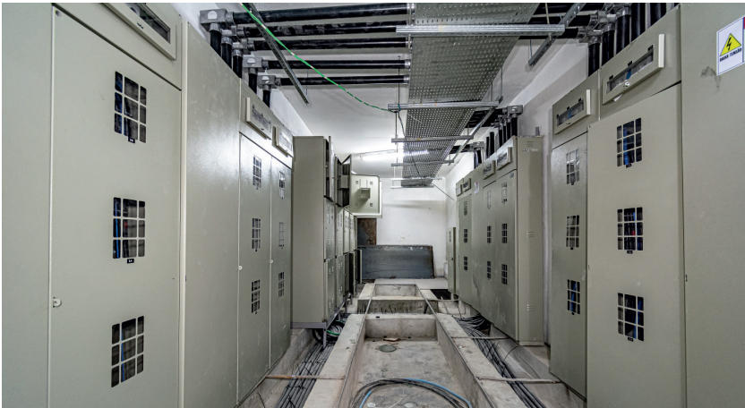
Entrada de Energia TOTALMENTE MODERNIZADA FULLY MODERNIZED Power Input
